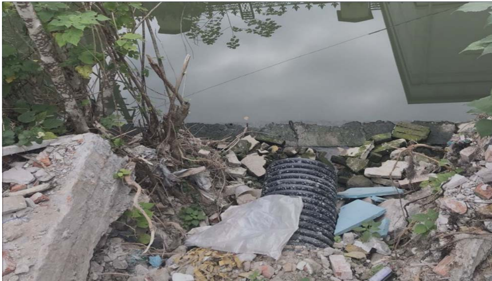
图 3-4 局部河道存在入河排污口
